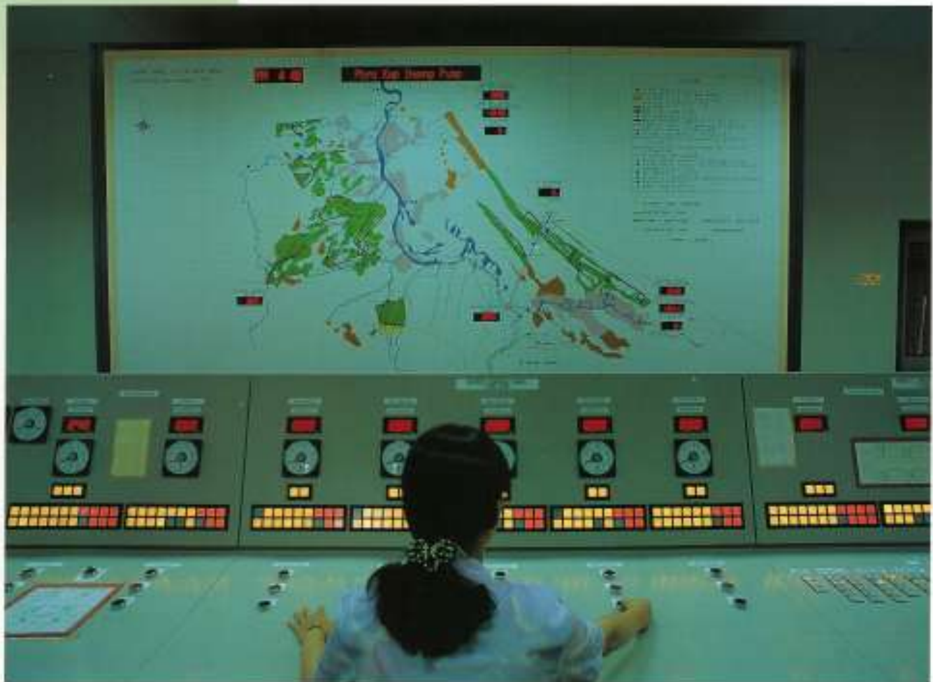
ห้องควบคุมการเปิด-ปิดประตู ระบายน้ำบางนา
