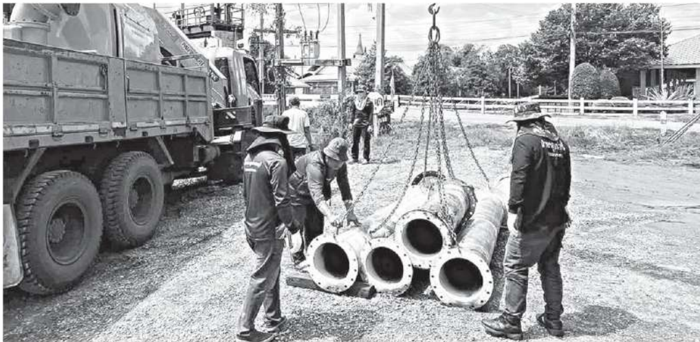
☒ เตรียมพร้อม... นายทวีวัฒน์ สืบสุขมันสกุล ผู้อำนวยการสำนักเครื่องจักรกล กรมชลประทาน มอบหมาย นายดุสิต ศิริมงคลยัง ผอ.ส่วนเครื่องจักรกลสูบน้ำ พร้อมเจ้าหน้าที่ติดตั้งเครื่องสูบน้ำ ณ ประตูระบายน้ำคลองนกกระทุง อำเภอบางเลน จังหวัดนครปฐม เพื่อเตรียมความพร้อมรองรับสถานการณ์น้ำในช่วงฤดูฝน โดยปัจจุบันดำเนินการติดตั้งแล้วเสร็จและพร้อมใช้งาน
