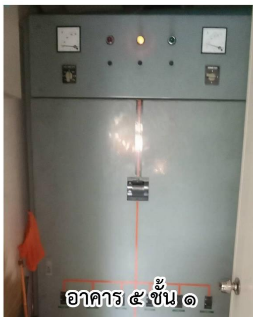
จุดตัดกระแสไฟฟ้า บริเวณข้างลิฟต์ อาคาร ๕ ชั้น ๑
