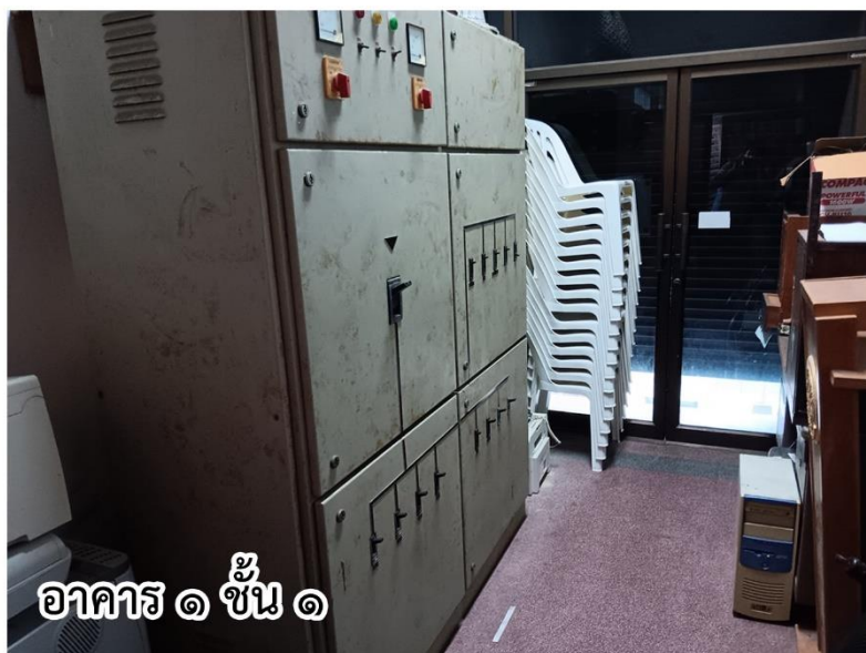
จุดตัดกระแสไฟฟ้า บริเวณฝั่งกองกลางห้องเก็บของด้านในสุด
