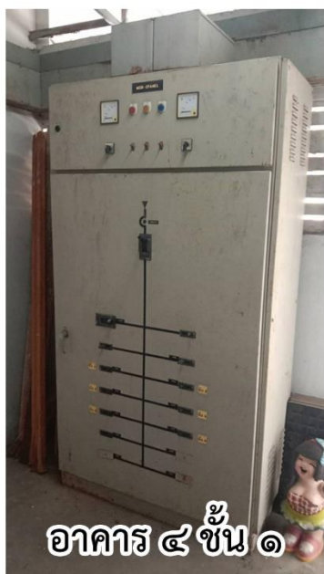
จุดตัดกระแสไฟฟ้า บริเวณข้างลิฟต์ อาคาร ๔ ชั้น ๑
