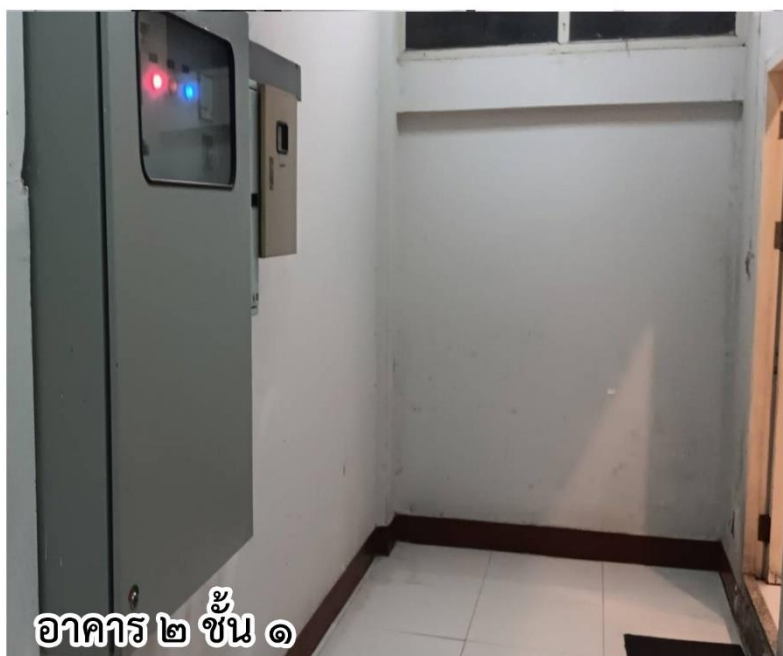
จุดตัดกระแสไฟฟ้า บริเวณหน้าห้องน้ำชาย-หญิง ชั้น ๑
